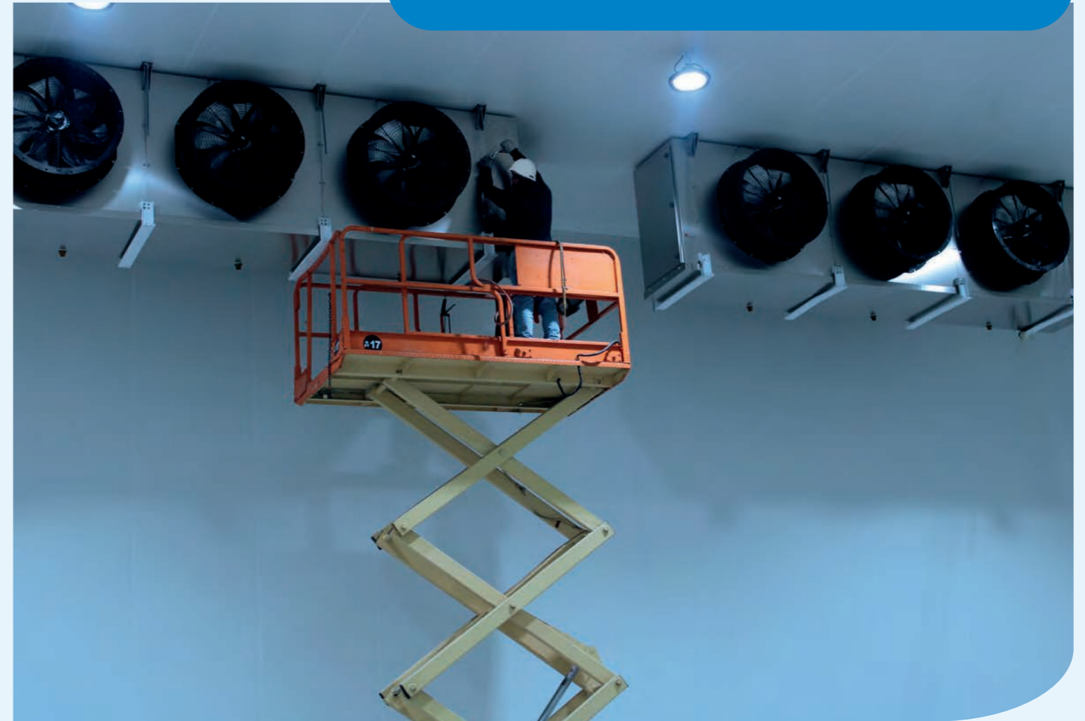
Proyecto realizado en 2018, consistente en suministro e instalación de 3 compresores tornillo para amoníaco de 200 HP cada uno, estos equipos se instalaron en el área de enfriamiento rápido ICE GEN.
